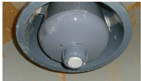
Ring-Jet vor und nach unseren Wartungsarbeiten
