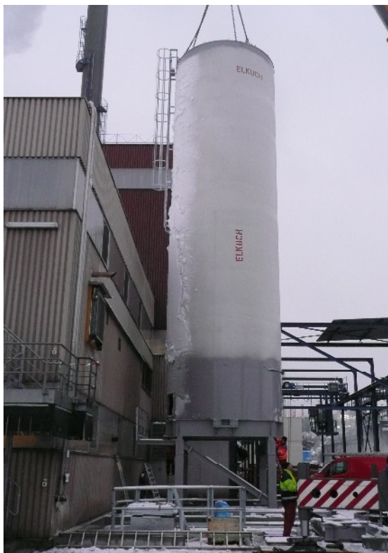
Dickschlammstapelsilo (300 m 3 ) zur Zwischenlagerung von eingedicktem Klärschlamm (TS-Gehalt ca. 20 – 30 %)
